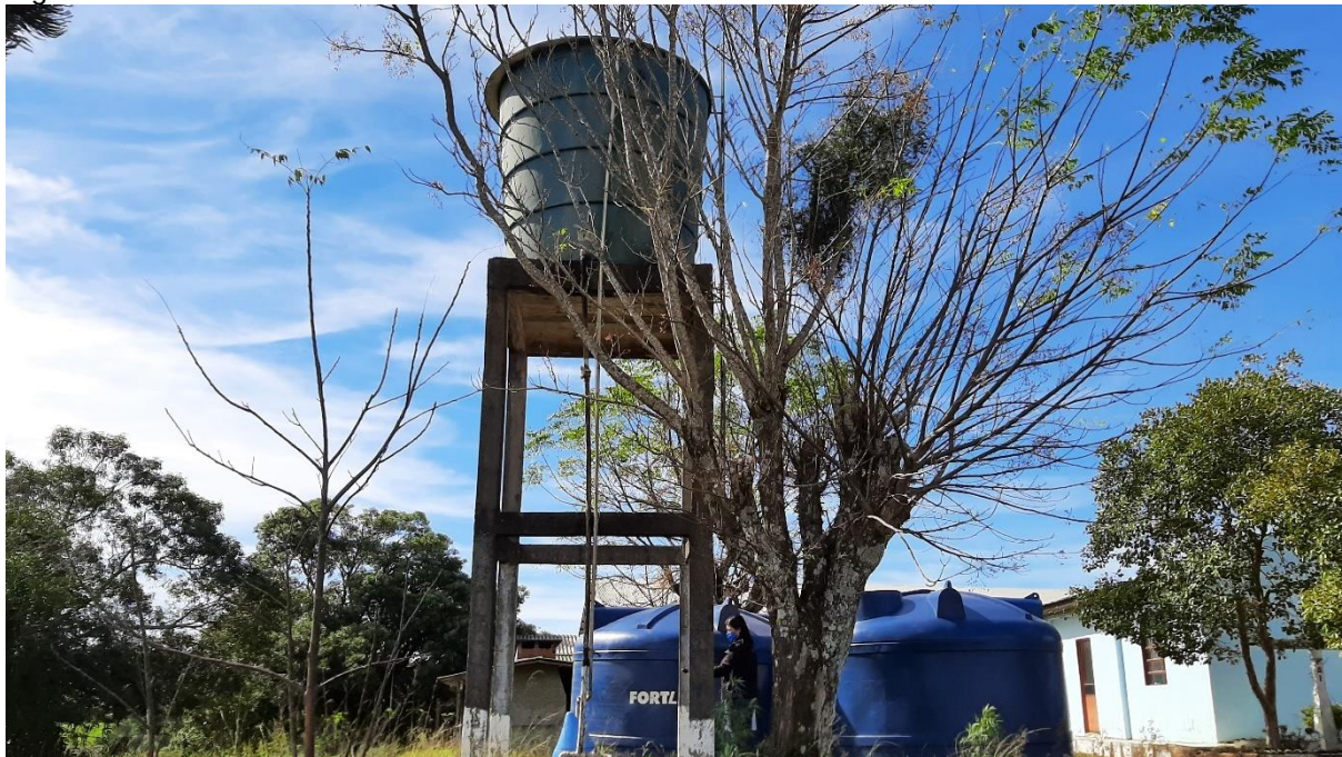
Figura 41: Reservatório em PRFV elevado – 15 m 3 - SAA Assentamento 25 de Maio – 06/2021.
