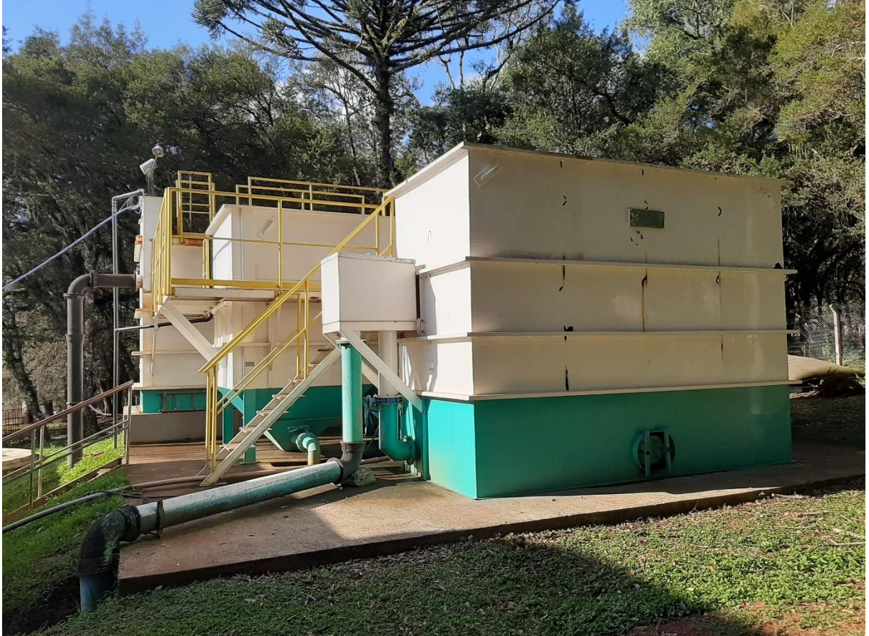
Figura 22: Estação de tratamento de água convencional - 06/2020.
