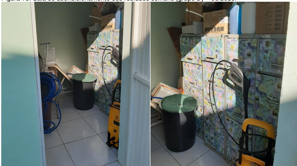
Figura 78: Sala de acondicionamento dos resíduos comuns (grupo D) – 06/2020.
