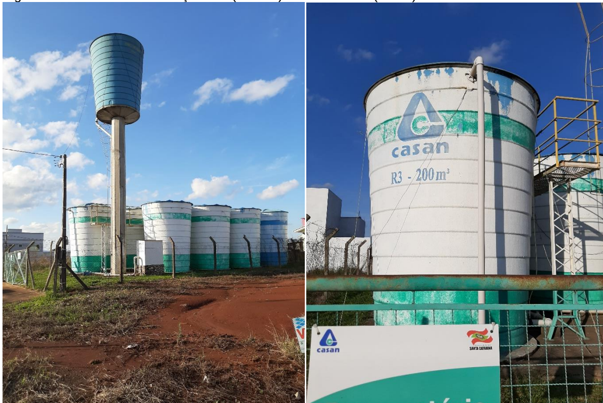
Figura 33: Centros de reservação R.3 (225 m³) e R.4 elevado (25 m³) – 06/2020.
