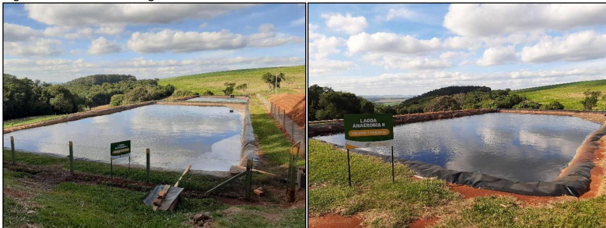
Figura 68: Sistema de lagoas anaeróbias I e II - 06/2020.
