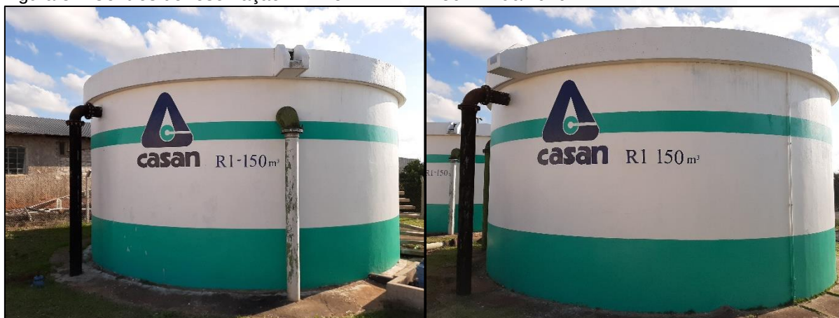
Figura 31: Centros de reservação R.1A e R.1B – 2x150m 3 - 06/2020.
