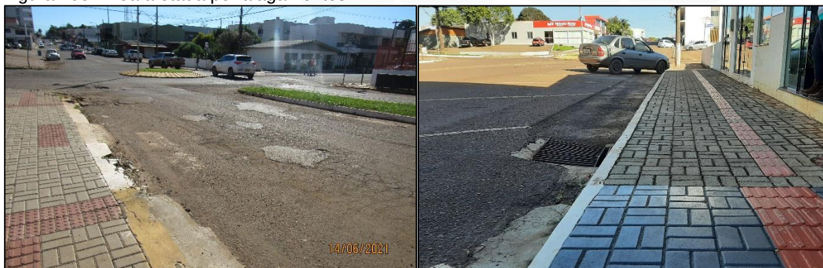
Figura 105: Área afetada por alagamentos.
