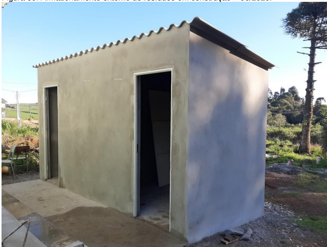
Figura 85: Armazenamento externo de resíduos em construção – 06/2020.
