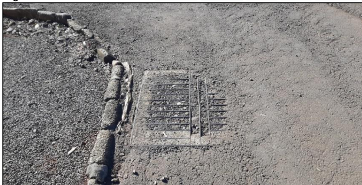
Figura 102: Boca de lobo obstruída.
