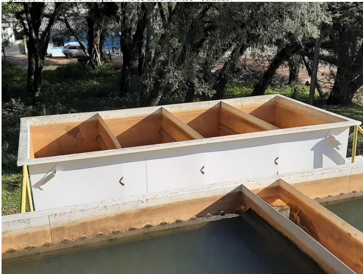
Figura 26: Unidade de filtração – Filtros ascendentes - 06/2020.
