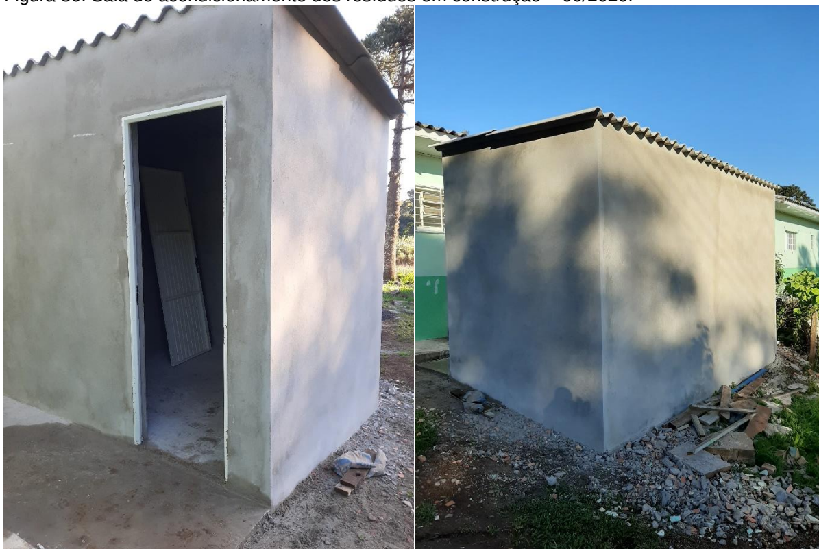
Figura 86: Sala de acondicionamento dos resíduos em construção – 06/2020.
