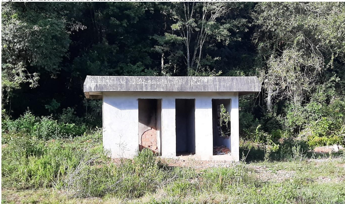
Figura 58: Estrutura civil do laboratório danificada – visita em 06/2021.
