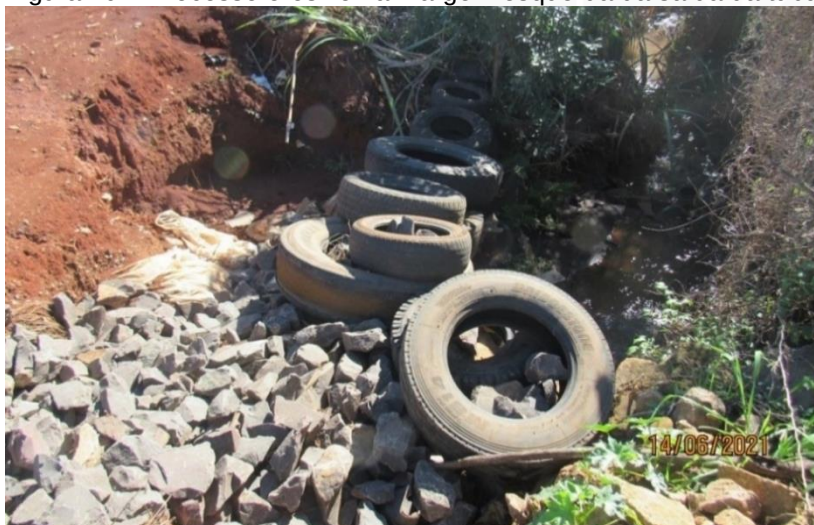
Figura 107: Processo erosivo na margem esquerda da saída da tubulação.
