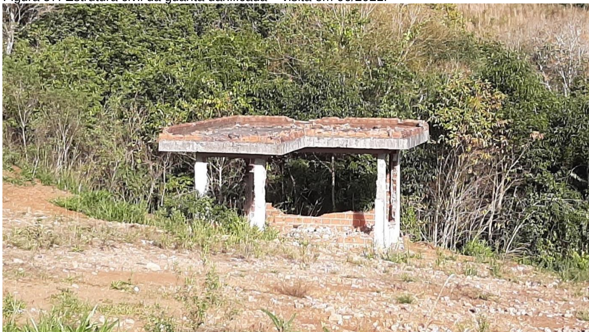
Figura 57: Estrutura civil da guarita danificada – visita em 06/2021.
