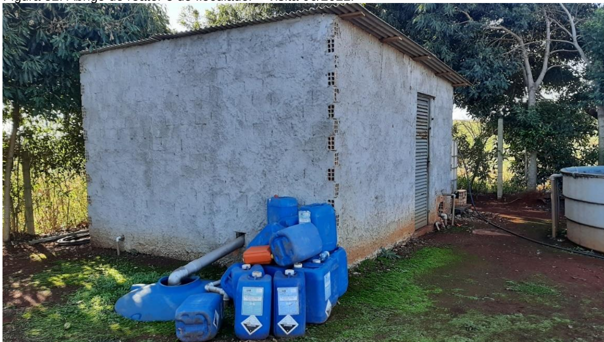
Figura 52: Abrigo do reator e do floculador – visita 06/2021.
