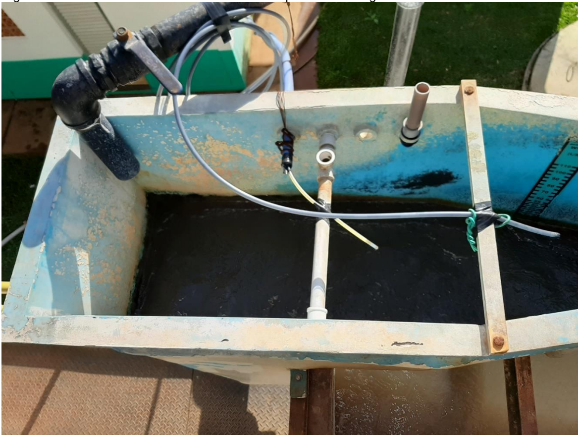
Figura 23: Calha Parshall – Medidor de vazão e ponto de dosagem de P.A.C - 06/2020.
