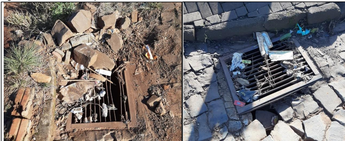
Figura 103: Boca de lobo parcialmente obstruída.
