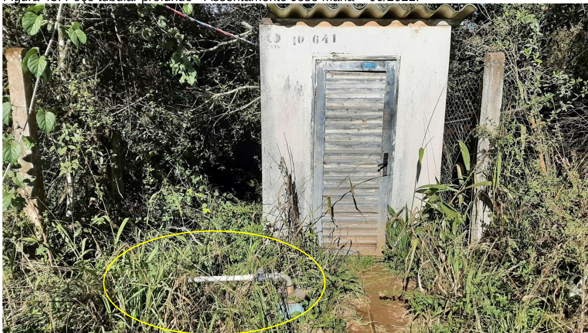
Figura 43: Poço tubular profundo - Assentamento José Maria – 06/2021.
