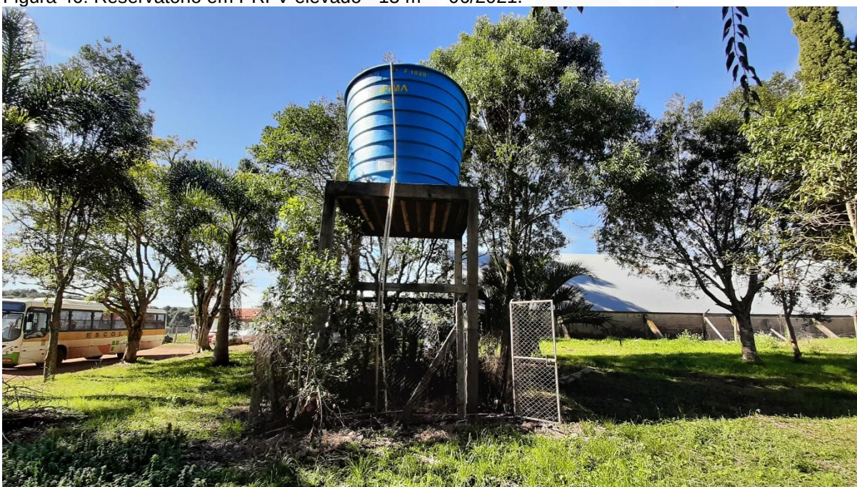
Figura 46: Reservatório em PRFV elevado - 15 m 3 – 06/2021.
