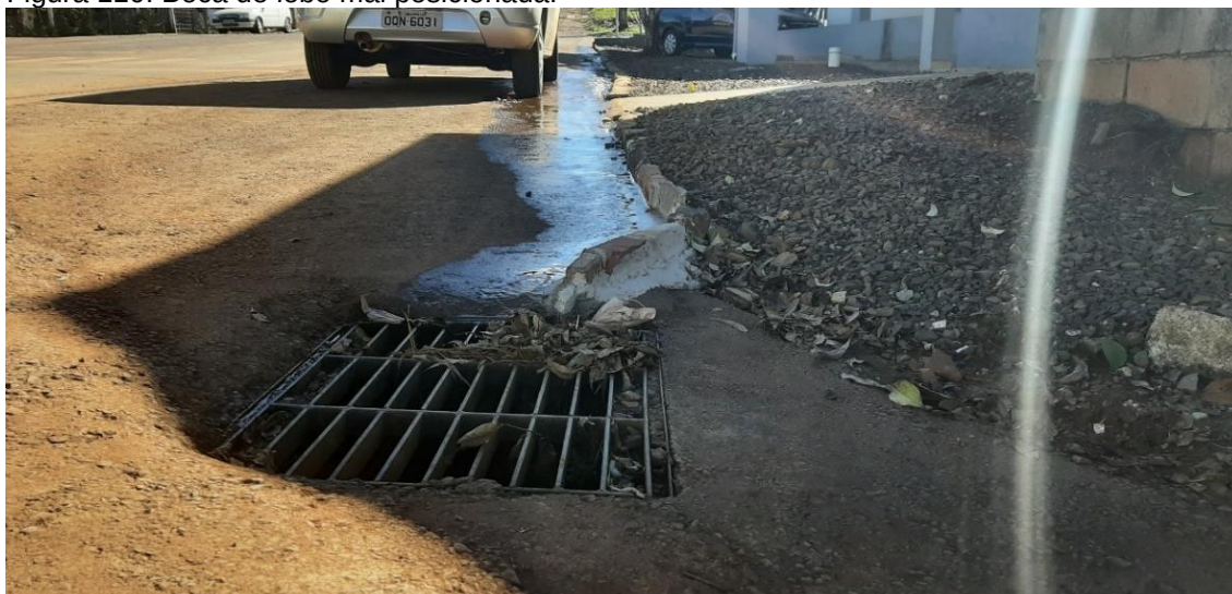
Figura 110: Boca de lobo mal posicionada.
