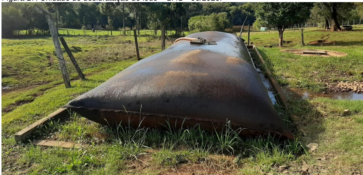
Figura 27: Unidade de desidratação de lodo – BAG - 06/2020.
