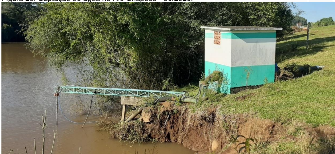
Figura 20: Captação de água no Rio Chapecó - 06/2020.
