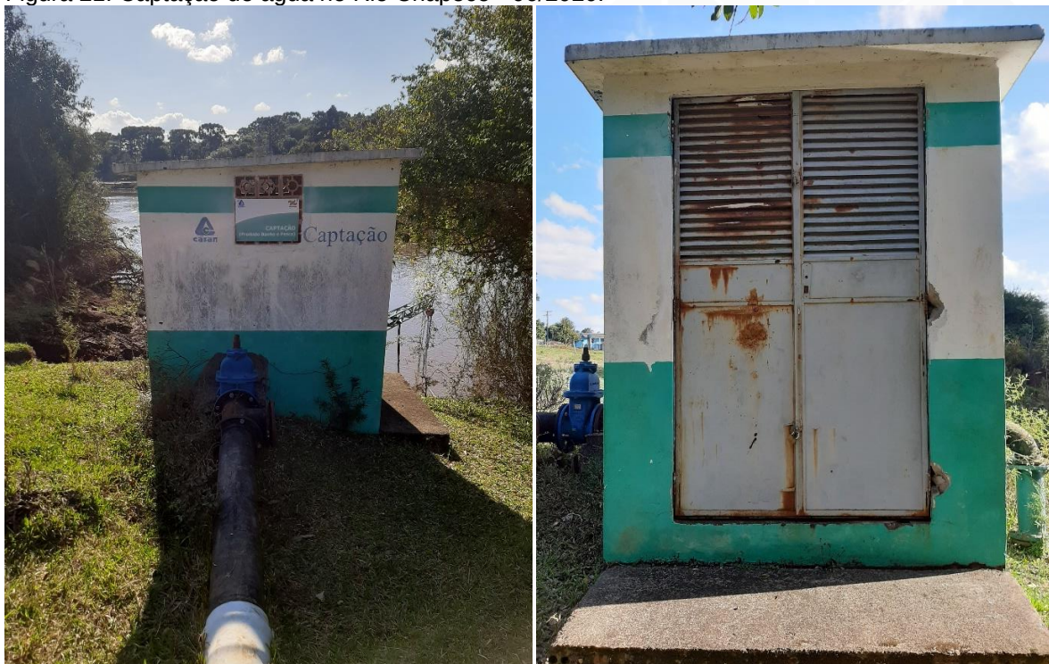
Figura 21: Captação de água no Rio Chapecó - 06/2020.
